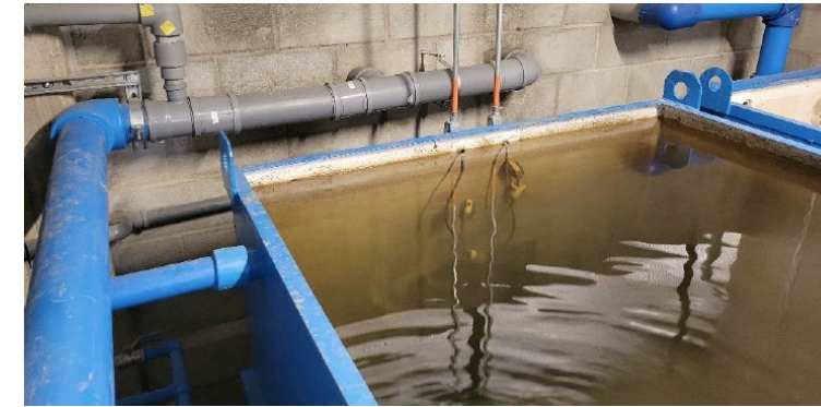
Foto 10. Tanques de agua lluvia. Créditos Green Loop
