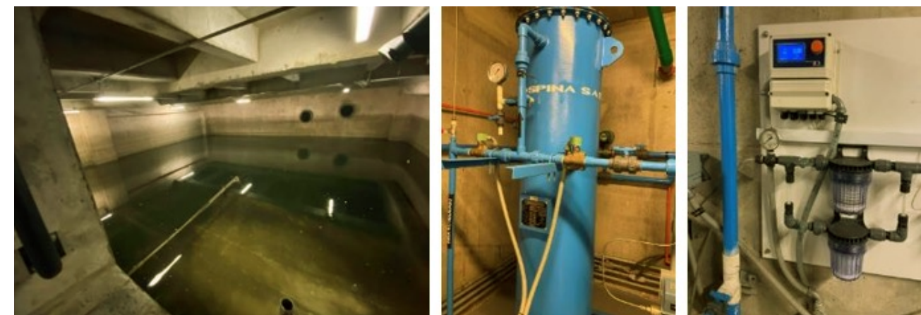
Foto 5. Sistema de captura y tratamiento de agua lluvia Aeropuerto El Dorado. Créditos Setri Sustentabilidad SAS
