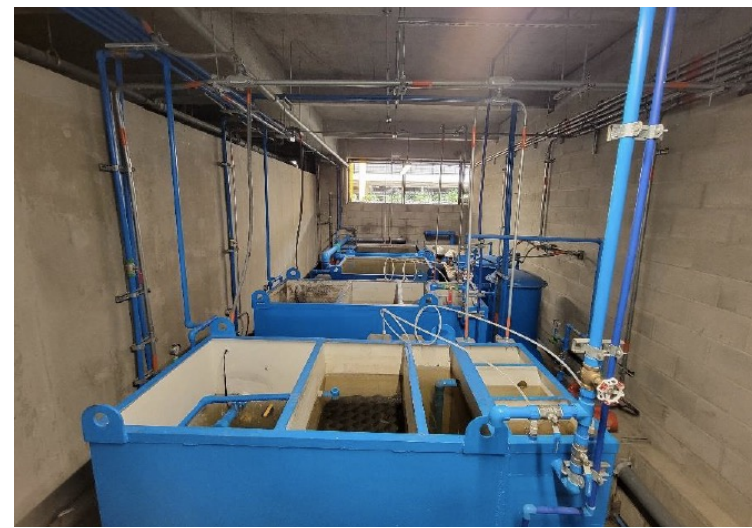
Foto 11. Tanques y sistema de tratamiento para agua lluvia. Créditos Green Loop.
